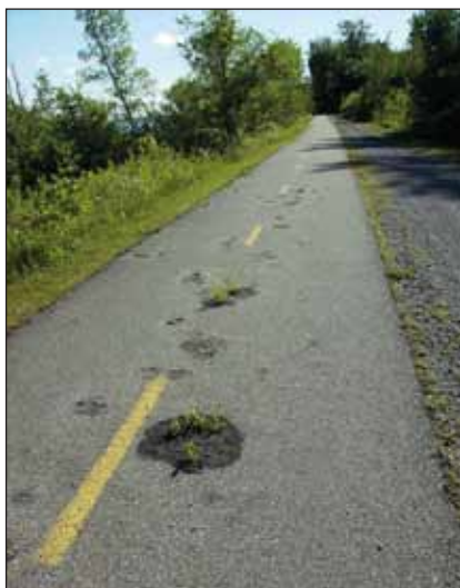
Déformation de la chaussée (drageons de saules) © MRC Beauharnois-Salaberry
